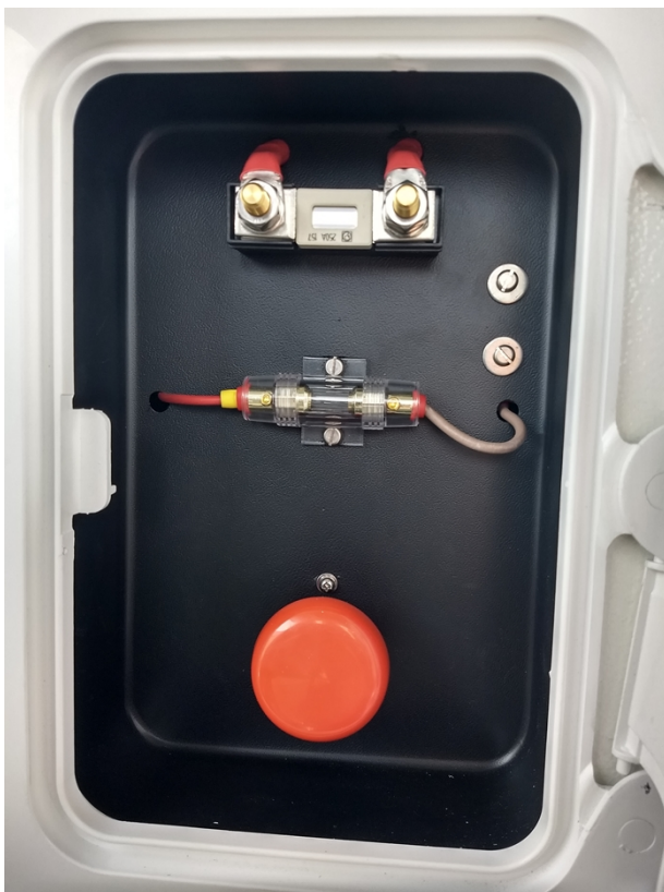
Hovedsikring og nødstop til baugpropell
